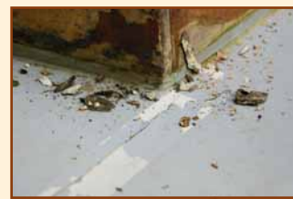
Hof Lomma, Risse im Deck, nahe der vorderen Ecke des Aufbaus
