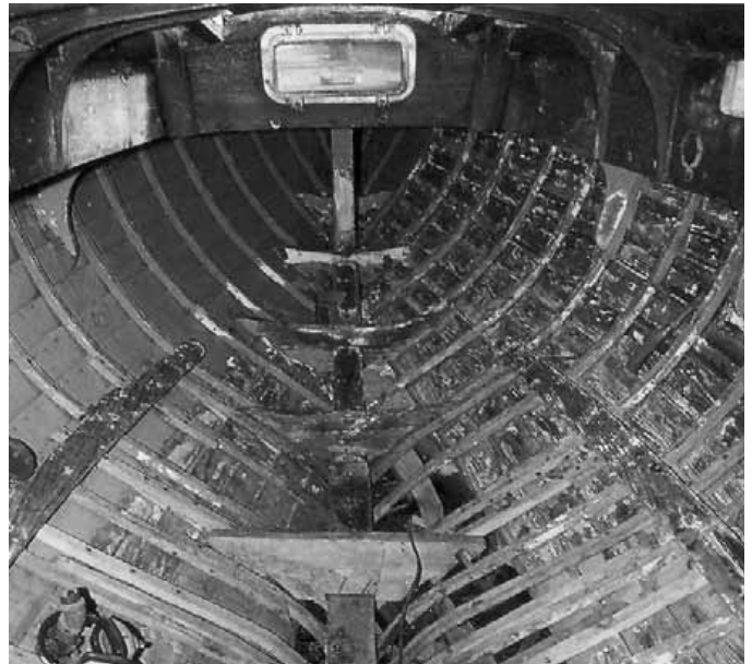
Die meisten der originalen Spanten waren noch gesund.
